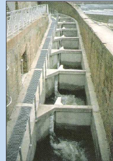
Foto 5: Scala con fessura verticale (Francia-Garonna).
