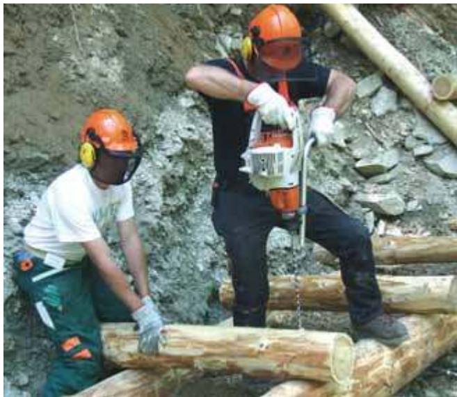
PALO TRATTENUTO POCO EFFICACEMENTE: PROBLEMI DI VIBRAZIONE
